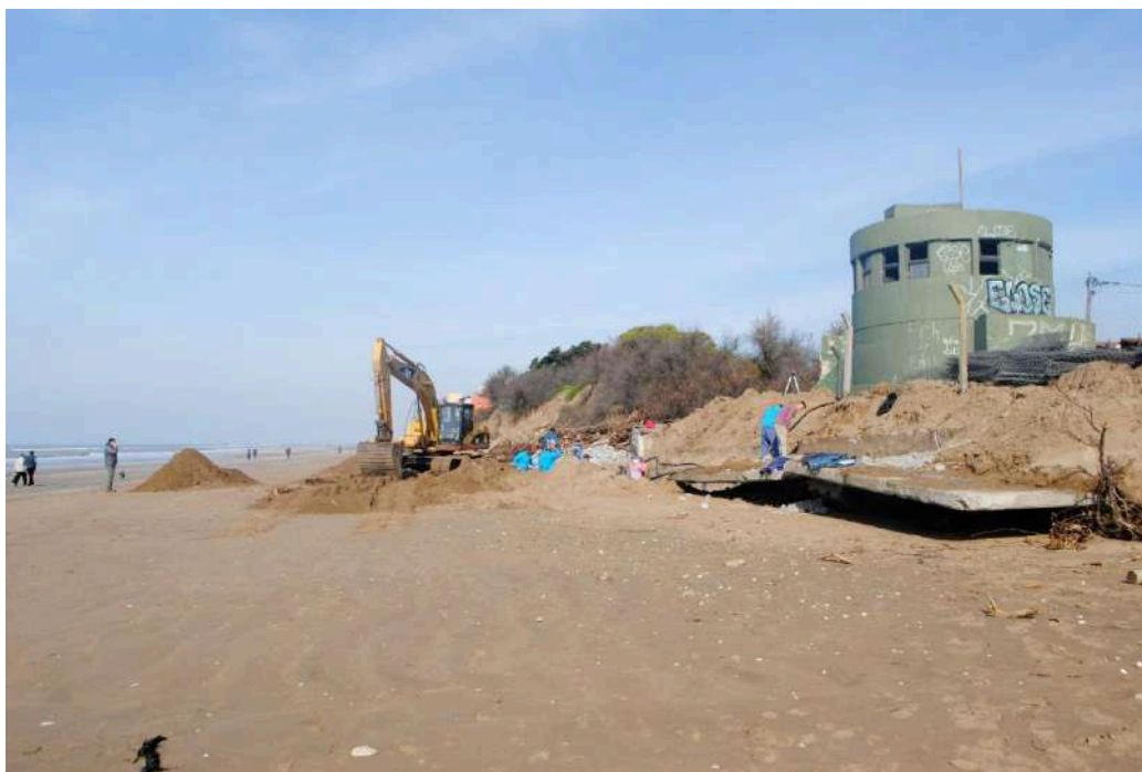
Figura 73: Socavamiento de la base de la estructura de la planta impulsora cloacal de la calle 38 y costanera en 2021. Evidencia de retroceso costero.
