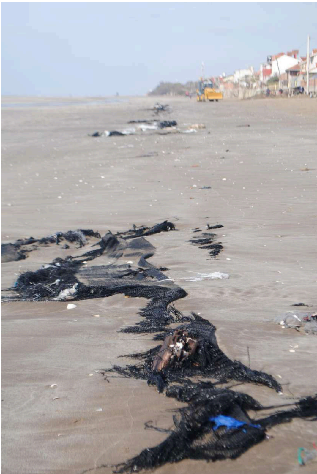
Figura 74: Exposición de bolsas geotextiles en la playa de las Toninas. Evidencias de erosión marina.
